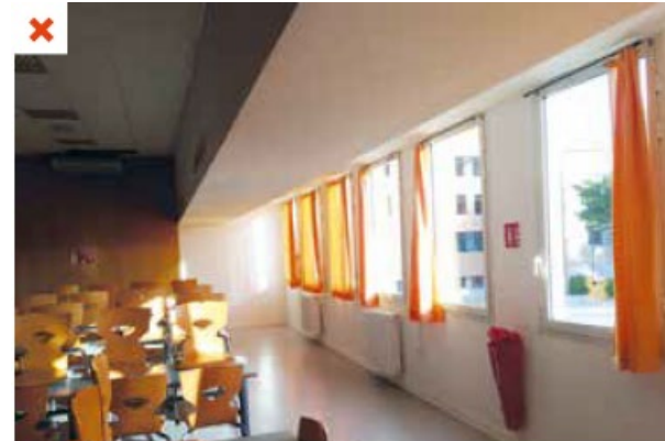
Rideaux intérieurs qui n'empêchent pas les surchauffes d'une salle de réunion. ©AQC
